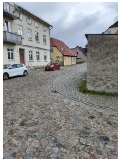
Abbildung 5: Fahrbahnoberfläche Glambecker Nebenstraße
